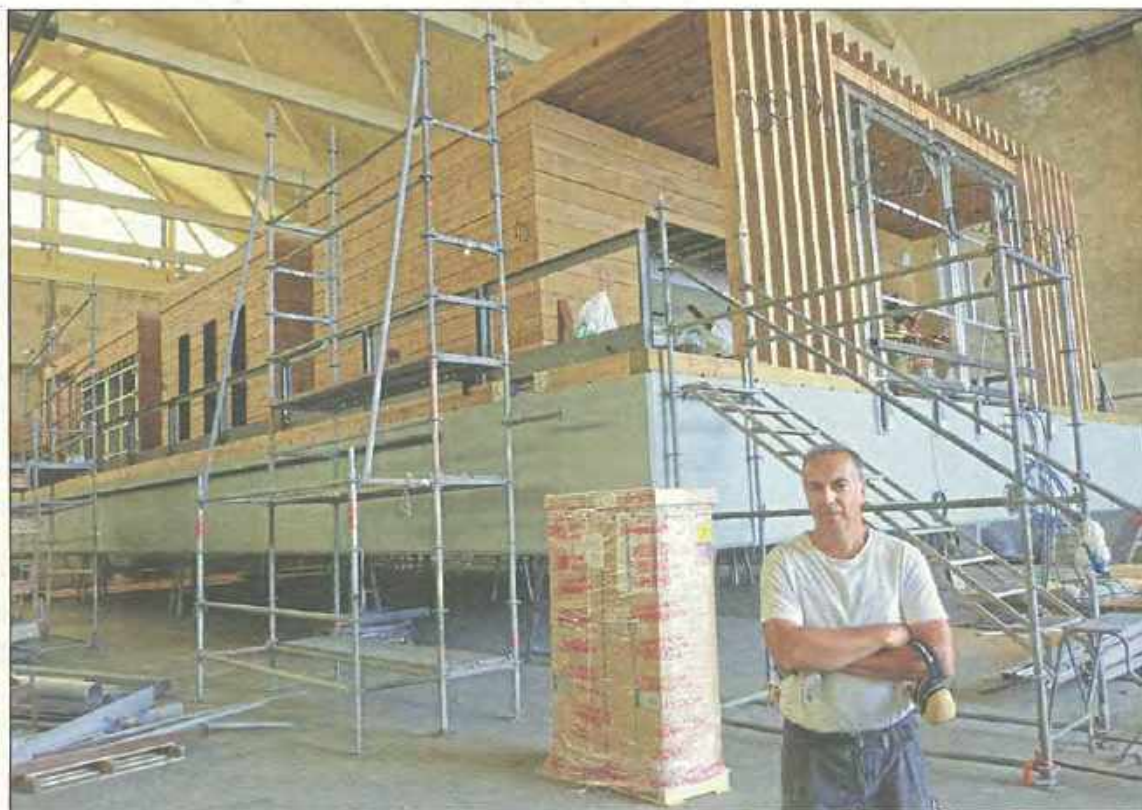
Frédéric De Rovère, directeur du chantier Transmétal Industrie, supervise au quotidien l'avancement de la construction de la future gare maritime de Marseille. (Photos M. G.)
