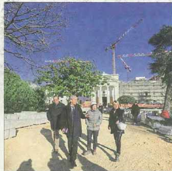
L'architecte du projet, Corine Vezzoni (à droite), a fait visiter le chantier à l'équipe municipale. Fin des travaux prévue en septembre prochain.
